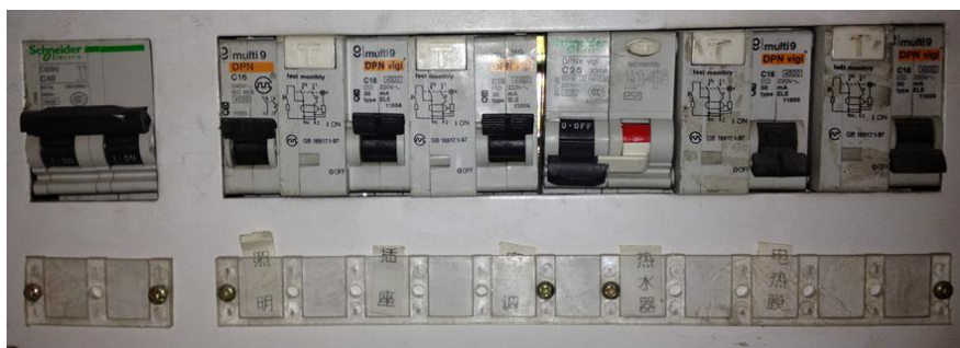
门厅处电闸箱内部（图 2）
