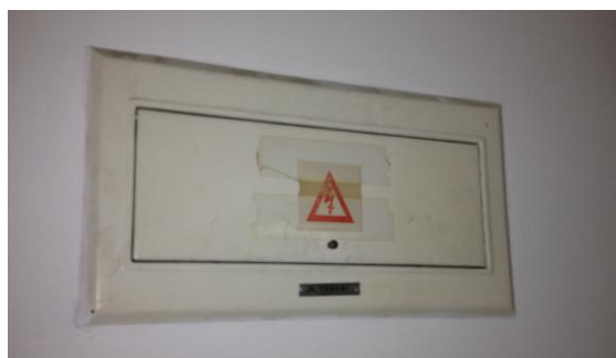
电闸箱外部(图 1)
